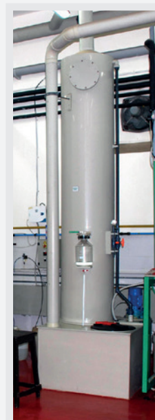
Fumes Scrubber Oxidizing wash Torre di lavaggio fumi ossidante Mumbai (INDIA)
