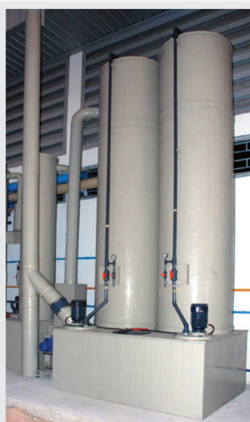
Fumes Scrubbers Torri di abbattimento fumi Chonburi (THAILAND)
