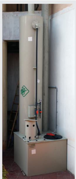
Fumes Scrubber Oxidizing wash Torre di lavaggio fumi ossidante Hyderabad (INDIA)
